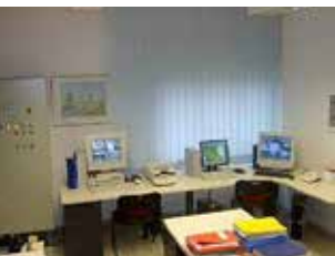
Stazione di controllo
