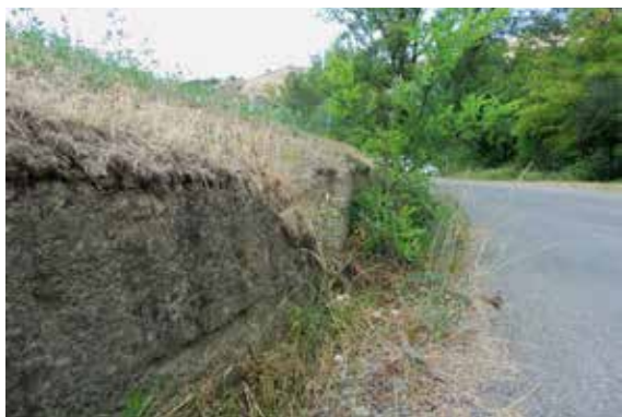
Smottamento causato da lavorazioni troppo vicine al margine stradale
