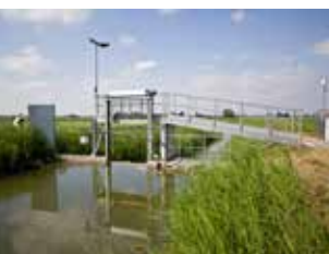
Paratoia automatizzata e telecontrollata
