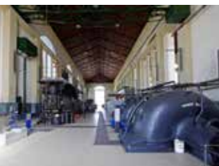
Pompe all'interno dell'Impianto Idrovoro Pilastresi
