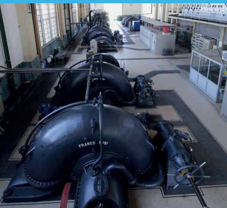
Interno impianto Pilastresi
