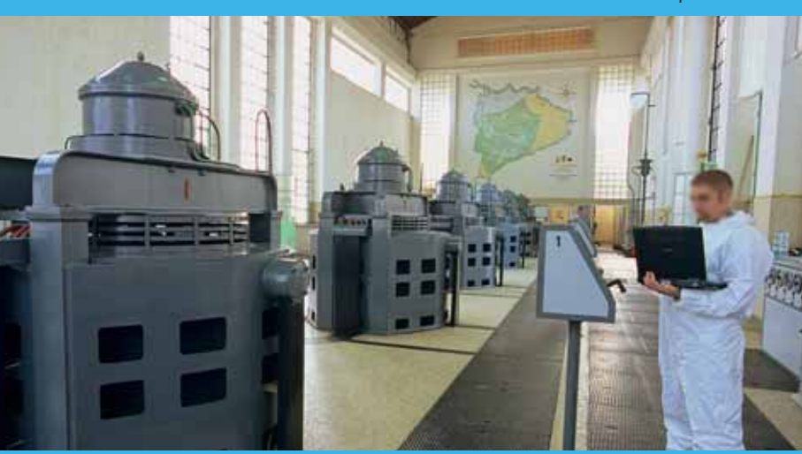
Interno impianto Sabbioncello
