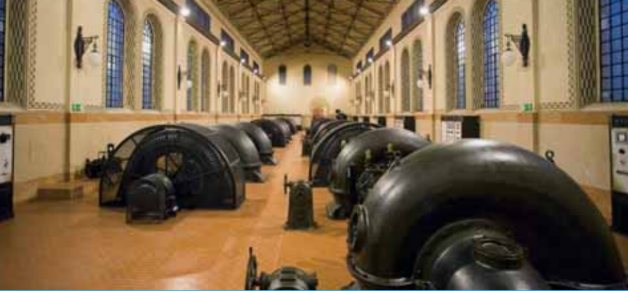
Interno impianto Bondeno Palata
