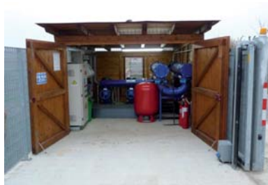
La stazione di pompaggio, il sistema di filtrazione e la centralina di gestione
