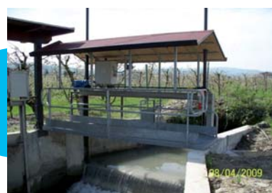
La paratoia di intercettazione delle acque del Canale di San Pietro per il Canale Diamante.
