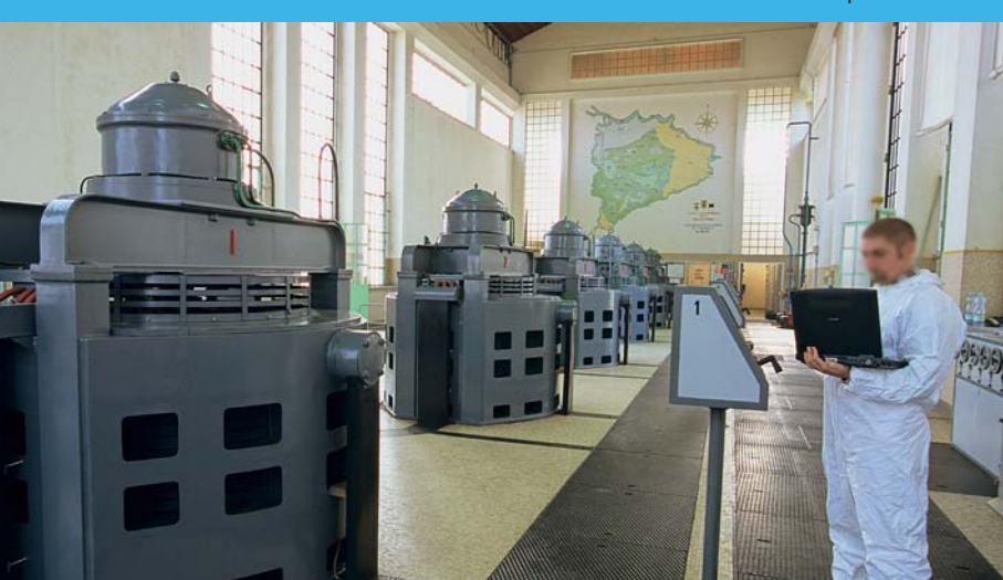
Interno impianto Sabbioncello
