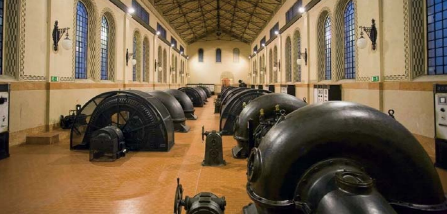
Interno impianto Bondeno Palata
