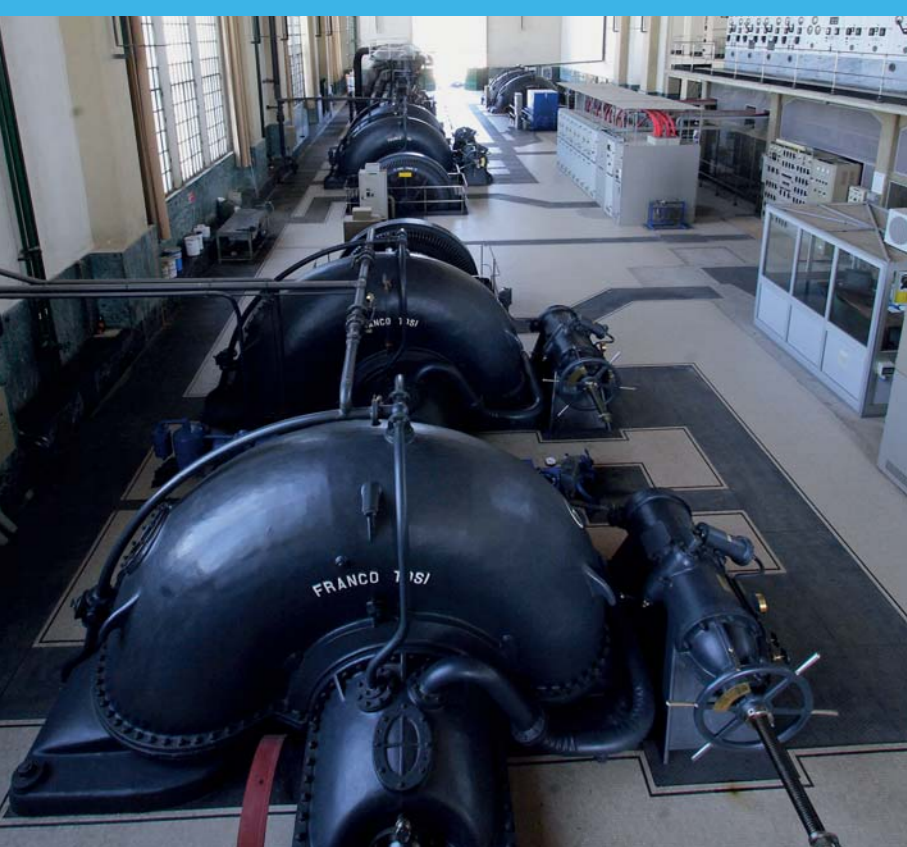
Interno impianto Pilastresi
